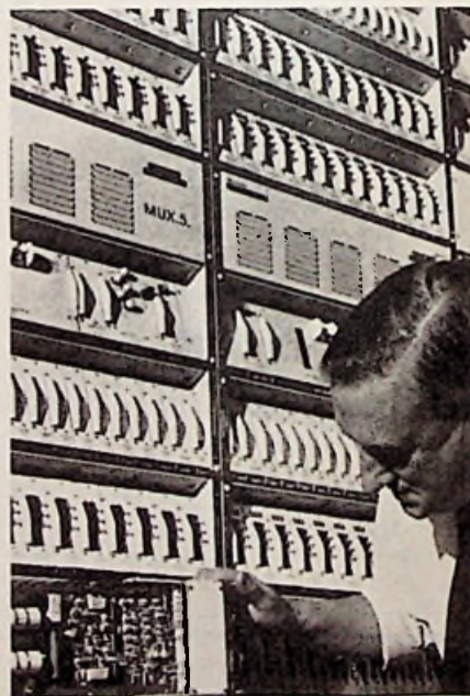
een deel van de 30-kanalen pulsmodulatie-apparatuur voor telefonie
